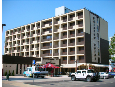
2010 hőszigetelés az új színek / korlát-mellvéd / burkolatok a felismerhetetlenségig megváltoztatják a megjelenését
