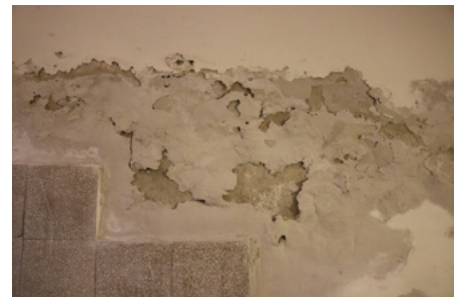
↑37 ázás nyomok, málló vakolat
