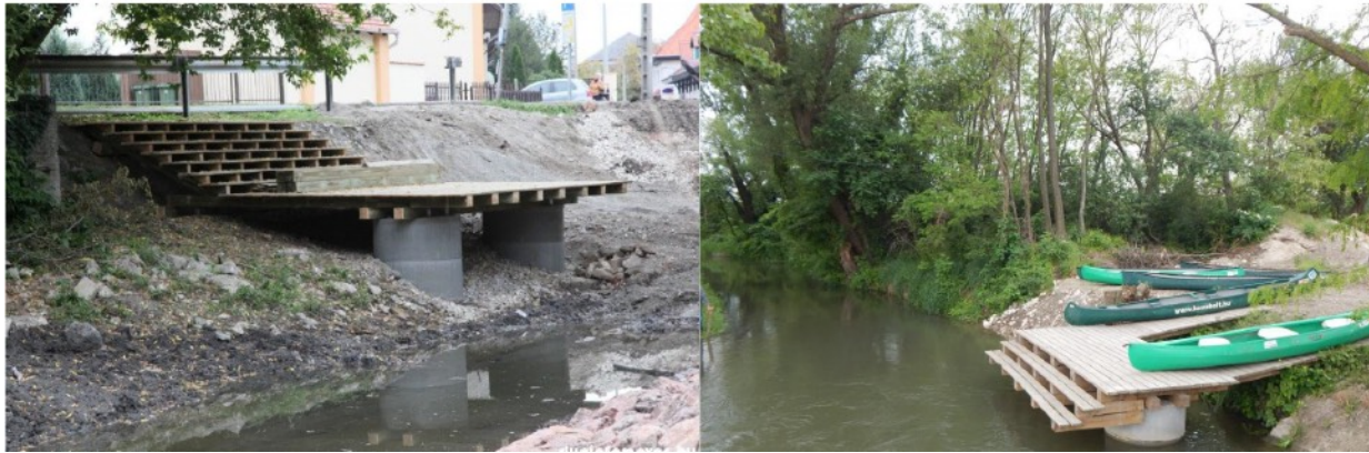
Beton kútgyűrűk használata a megállóhelyek mentén
