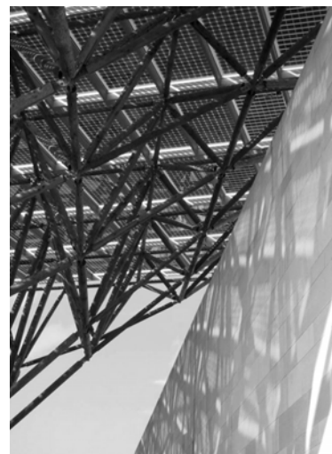
Fotovoltaikus tető / Feilden Clegg Bradley a
